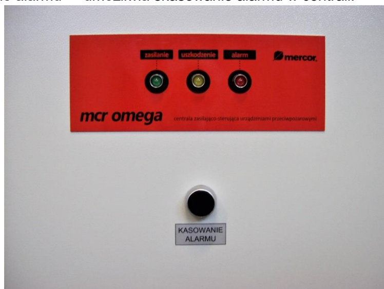
Rys. 3. Drzwi centrali – panel wizualizacji i przycisk Kasowanie alarmu.
