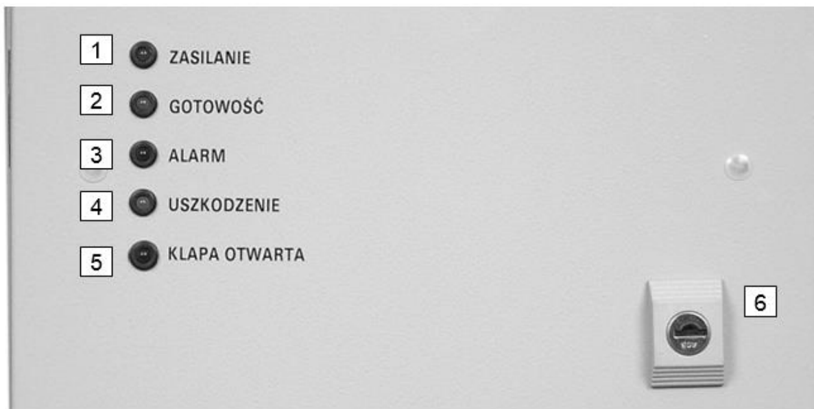
Fot. 1 Płyta czołowa centrali.
